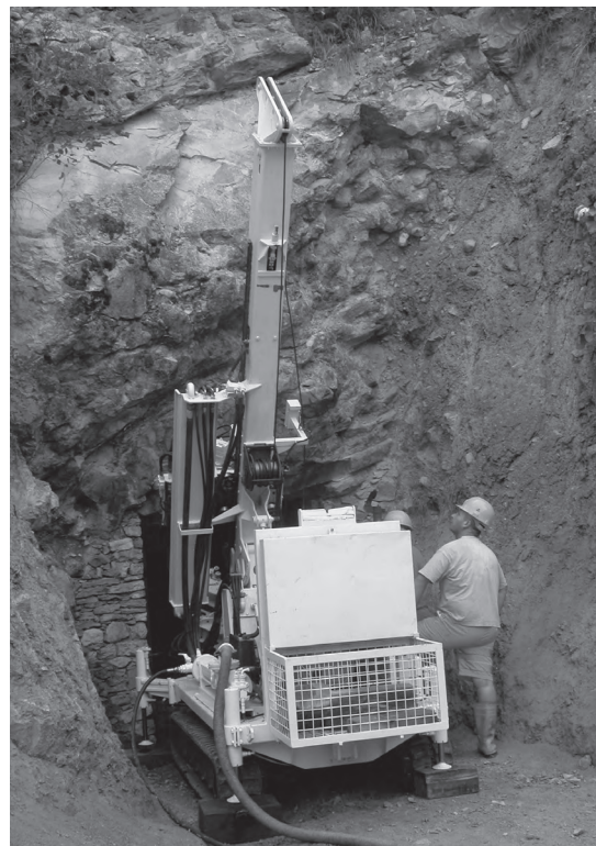
Fig. 2 - Carotiere posizionato all'imbocco della “Cava bassa”, la galleria scavata alla base della parete della Pesciara. Si noti il contatto laterale tra le rocce sedimentarie stratificate (a sinistra) e la breccia vulcanica (a destra).
